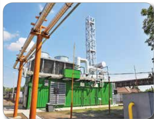
500 kW névleges villamos teljesítményű gázmotor.
